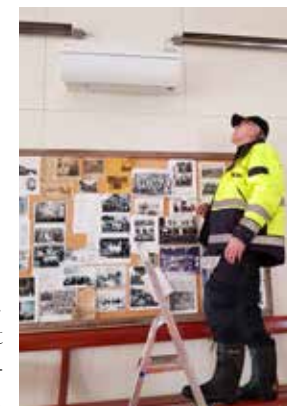
Vi har fått problem med värmepumparna i stora salen. Urban försöker hitta vad som är felet. Kylan kan vara ett problem, men nu är all is borta men fläktarna går fortfarande inte som de ska. Men vi jobbar på att lösa problemet.
